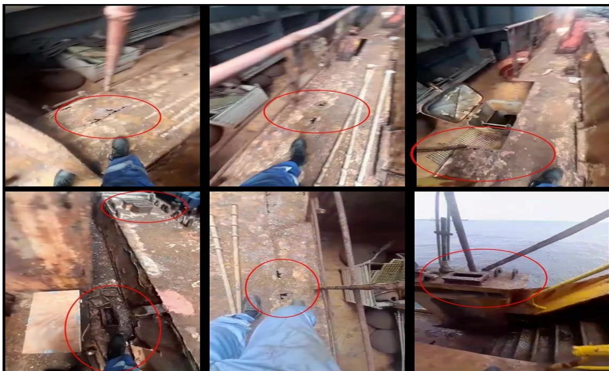
圖 1.11-4 天使輪主甲板存在破洞及鏽蝕照片
