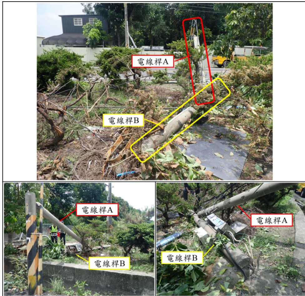
圖 1.4-3 遭電纜線拉扯而斷裂倒塌之電線桿
