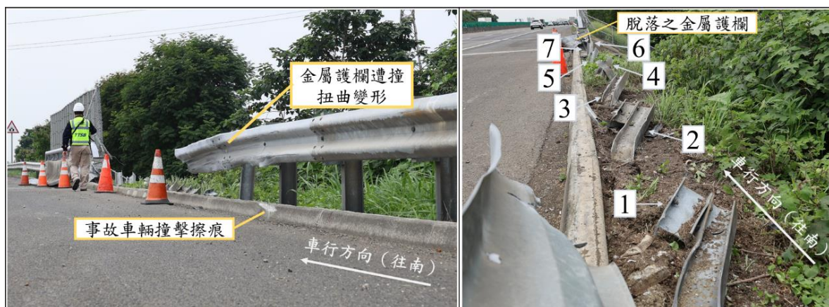
圖 1.4-1 遭撞毀之路側金屬護欄
