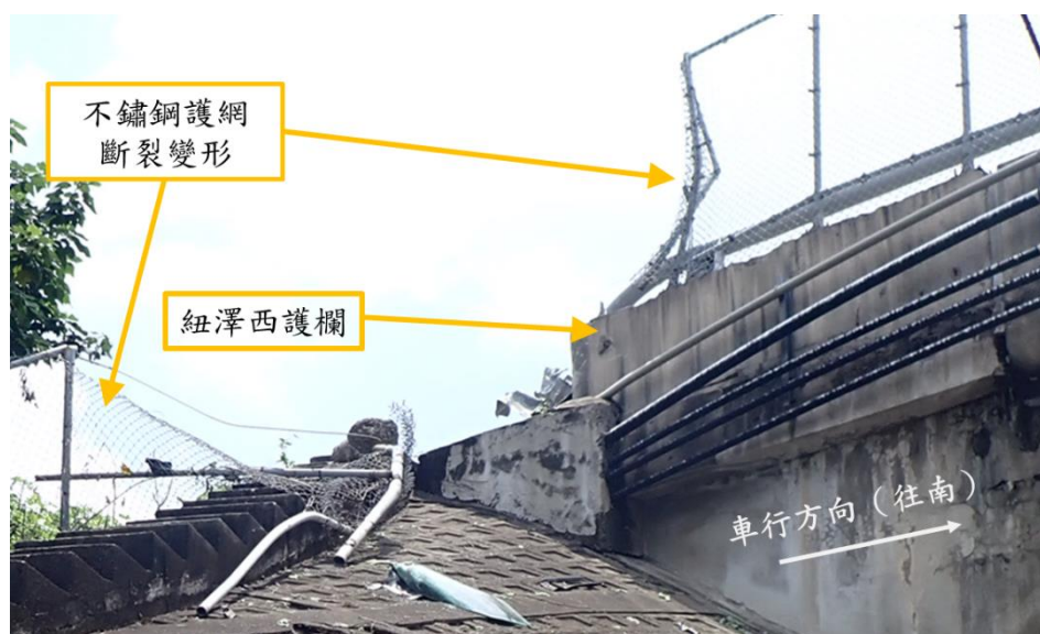
圖 1.4-2 遭撞毀之維修及逃生梯道不鏽鋼護網
