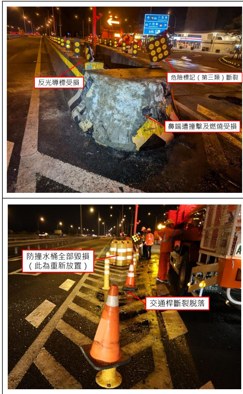
圖 1.4-1 道路設施損壞情形
