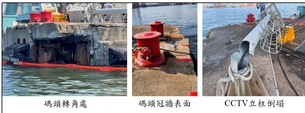
圖 1.3-3 89 號碼頭損害現場照片
