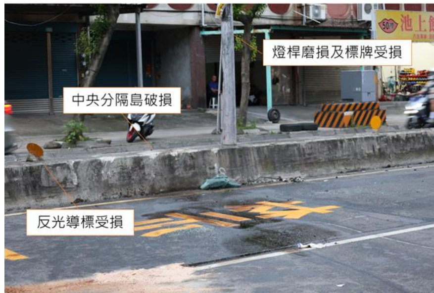
圖 1.4-1 道路設施損壞情形
