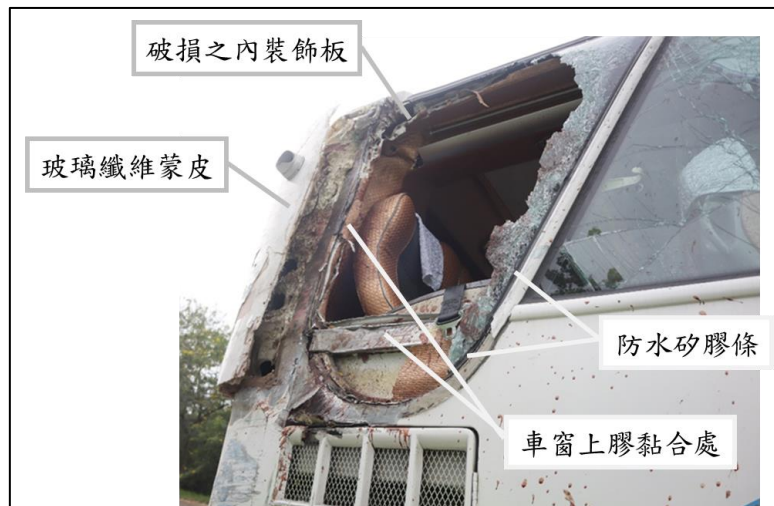
圖 2.3-1 事故大客車右側最後一排第 6 塊玻璃損害狀況
