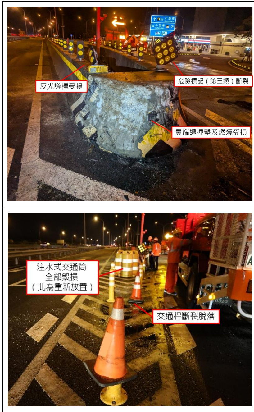
圖 1.4-1 道路設施損壞情形
