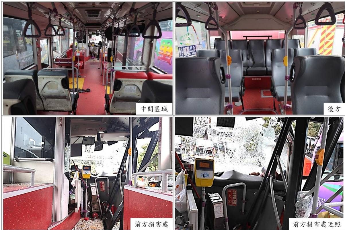
圖 1.3-2 事故車輛內部損害情形
