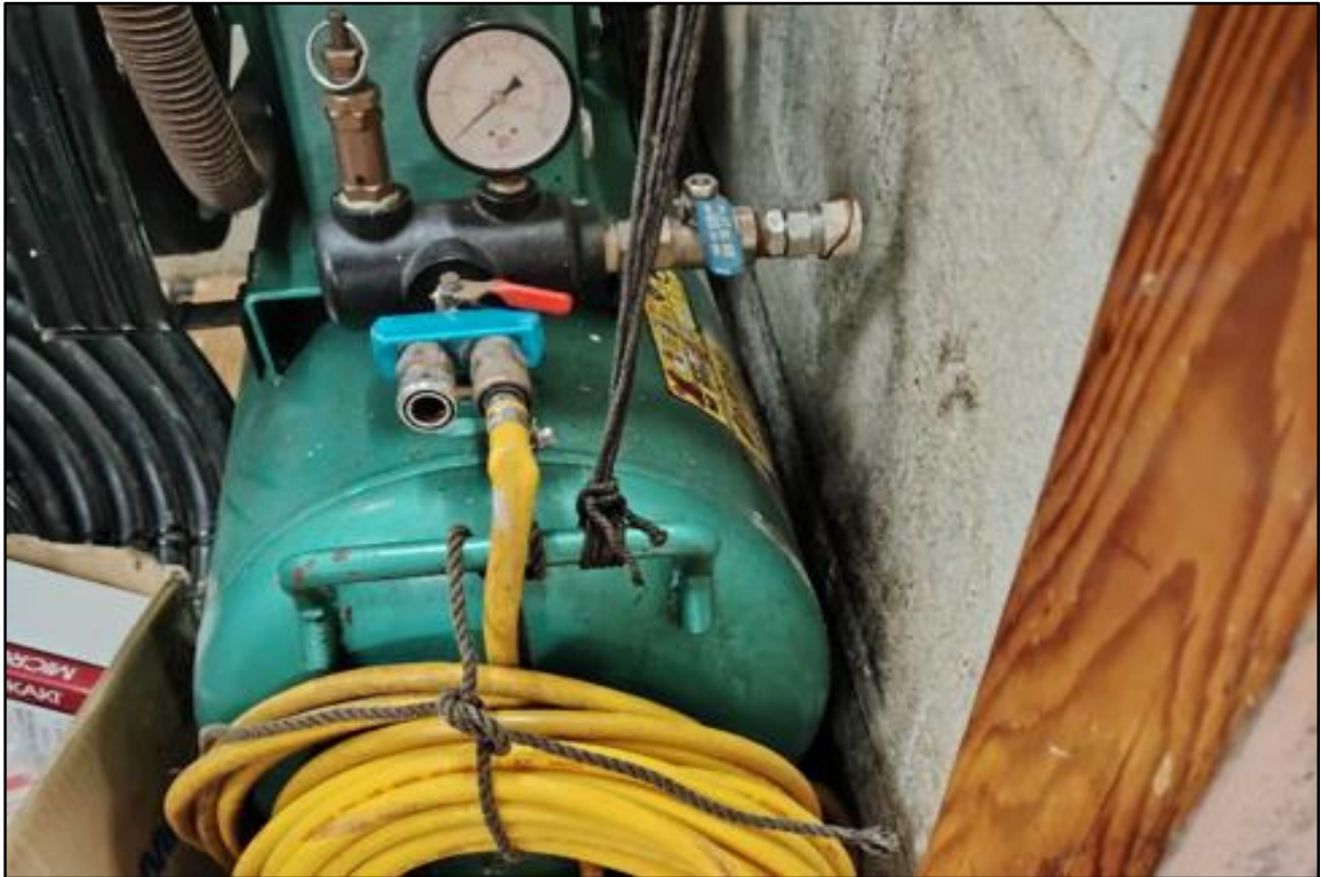
圖 1.6-4 「裕有」供氣至面罩的空氣壓縮機及空氣管（船東提供）
