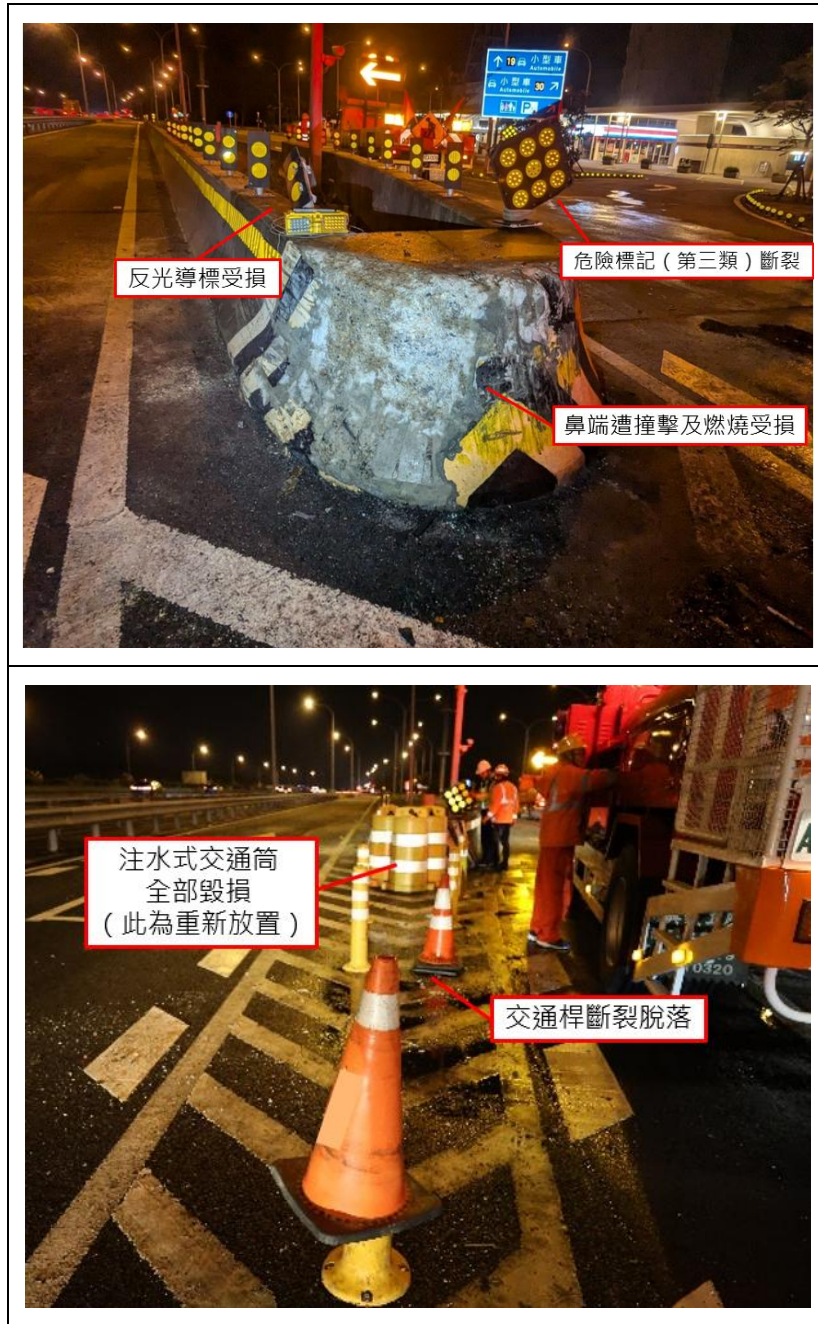
圖 1.4-1 道路設施損壞情形
