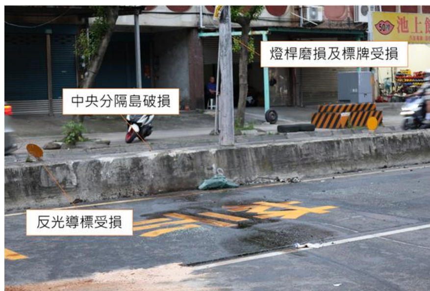
圖 1.4-1 道路設施損壞情形
