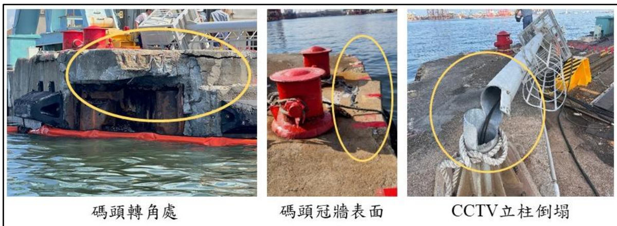
圖 1.3-3 89 號碼頭損害現場照片
