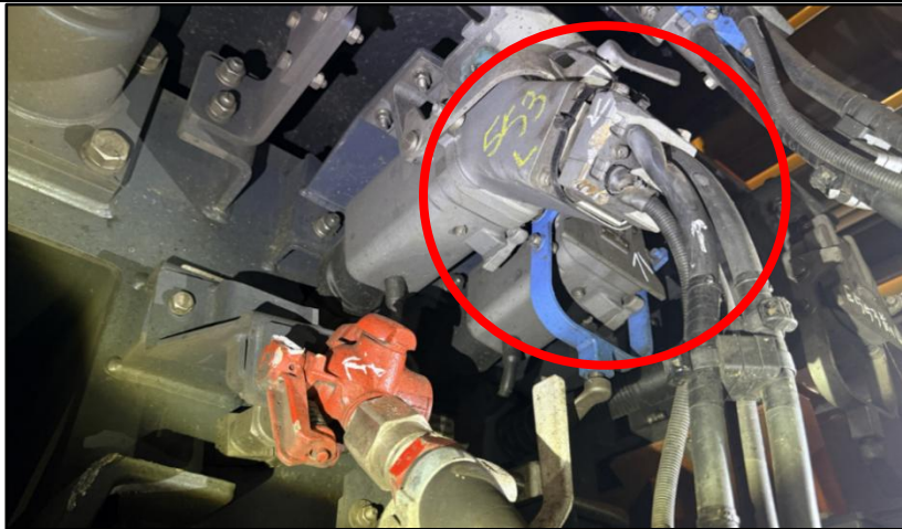
圖 4 電氣跳線座受損
