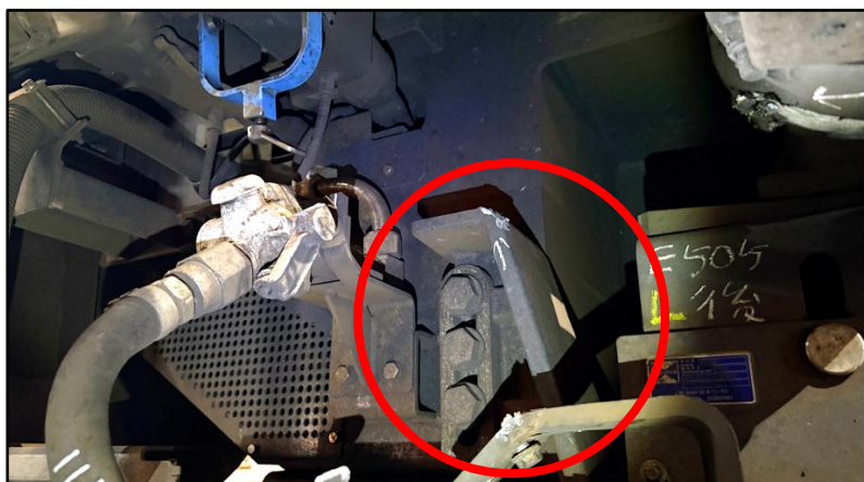
圖 3 聯結器限位裝置受損
