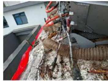
3-6 低壓通訊線破損
