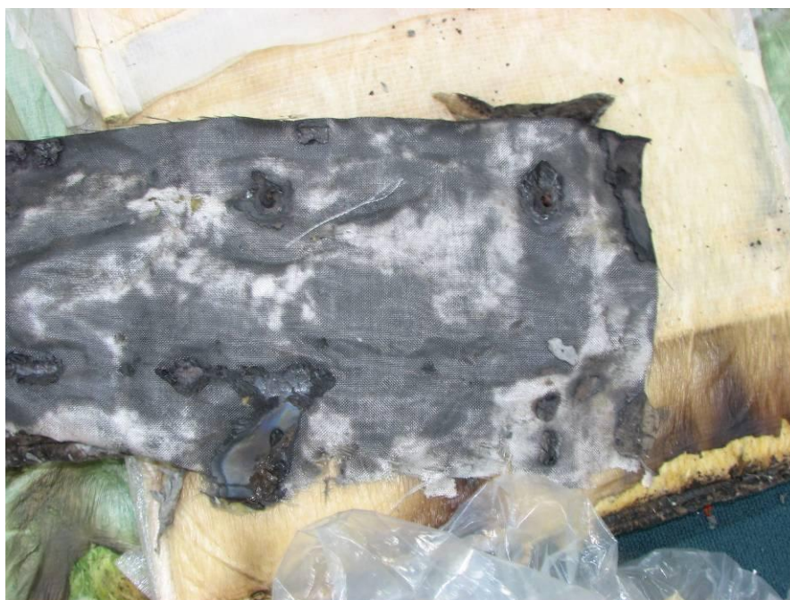
圖 2-8 側牆板隔熱毯焚毀碳化圖
