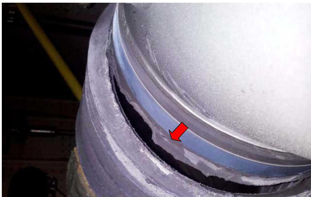
圖 2-9：CI 947 一號空調機冷凝器與混合器間連接管路破損
