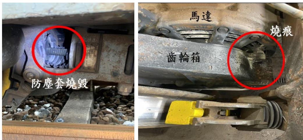
圖 2.1.3-3、圖 2.1.3-4 0428 臺鐵第 4206 次車新馬站重大鐵道事故照片
