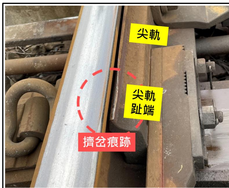
圖 2 南澳站第 19 號道岔尖軌
